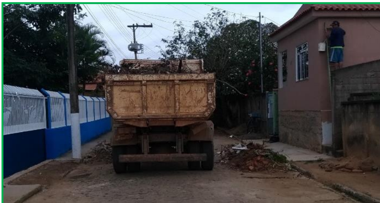
Figura 15 – Procedimento de coleta de RCCs pela Prefeitura. Fonte: Ideal Consultoria Ambiental e Urbanística LTDA.
