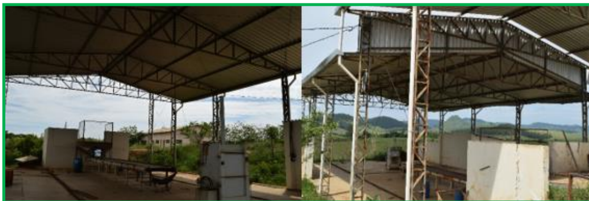
Figura 11 – Usina de Triagem – UT no Distrito de Conceição da Boa Vista. Fonte: Ideal Consultoria Ambiental e Urbanística LTDA.
