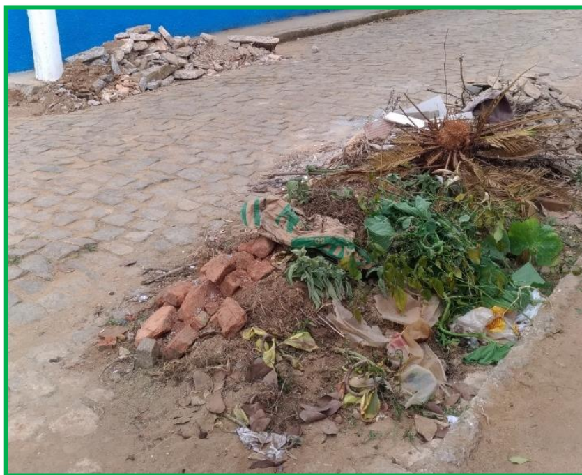
Figura 14 – Resíduo de construção civil dispostos de forma errônea em logradouros e sobre as calçadas do município.
